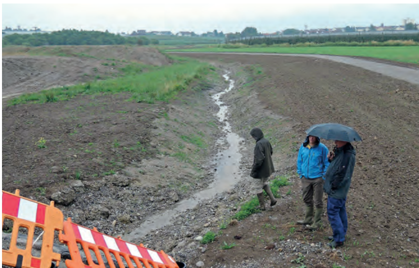
Abb. 2: Blick vom großen Rohrdurchlass auf den oberen Bereich des Abschnitts A nach Erstprofilierung und noch vor dem Anschluss an das bisherige Fließgewässer (Juli 2014). Das im künftigen Bachbett vorhandene Wasser hat sich direkt dort bei Regen angesammelt (Foto: J. Trautner).
